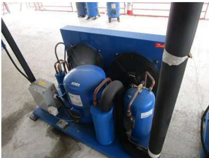
VISTA DOS COMPRESSORES
