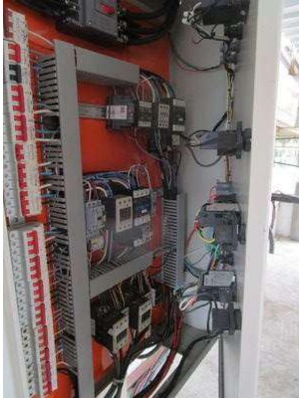
VISTA DO PAINEL DE CONTROLE DOS COMPRESSORES
