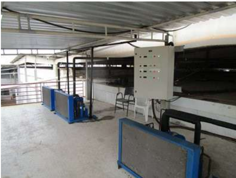
VISTA DOS COMPRESSORES
