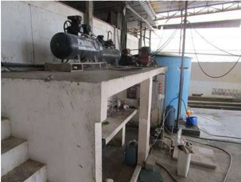
VISTA DOS COMPRESSORES DE AR
