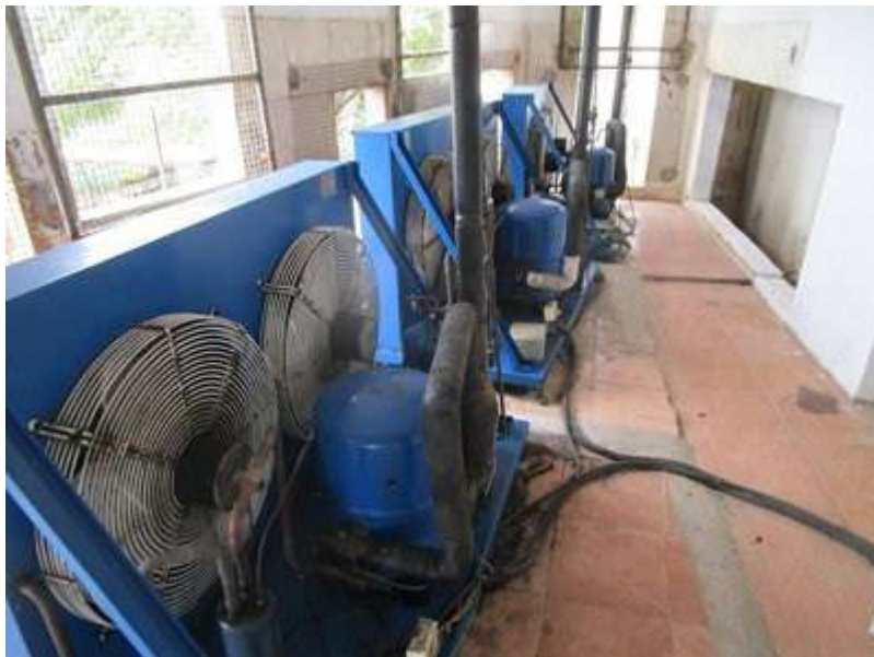
VISTAS DOS COMPRESSORES
