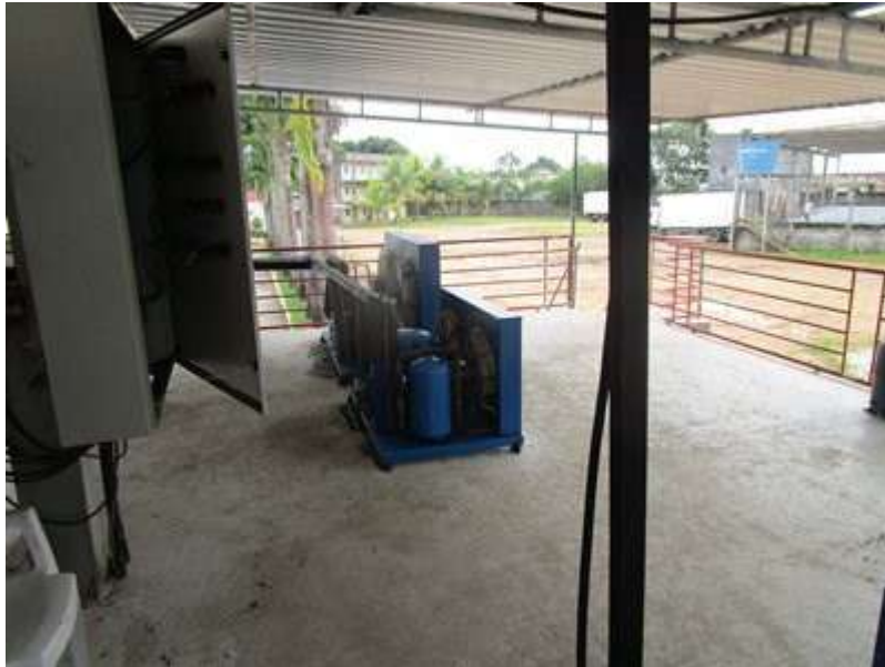
VISTA DOS COMPRESSORES
