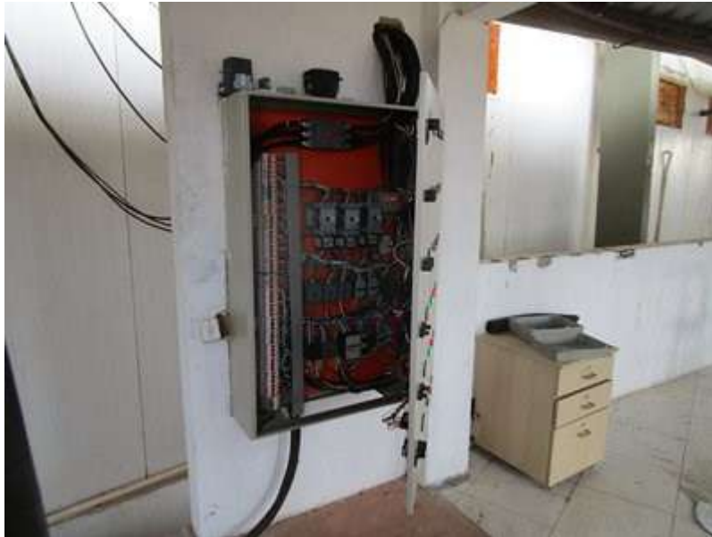
VISTA DO PAINEL DE CONTROLE DOS COMPRESSORES
