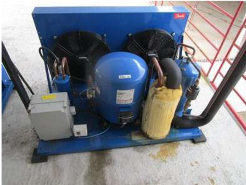
VISTA DOS COMPRESSORES
