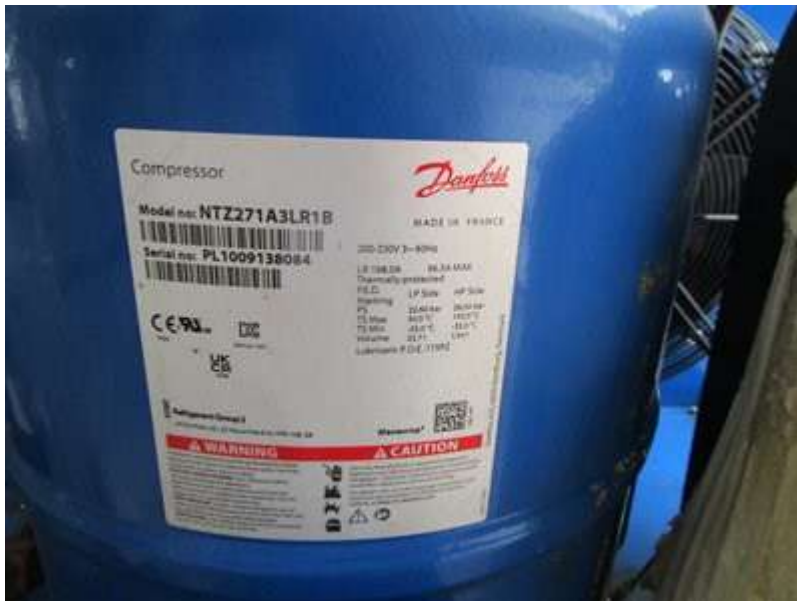
VISTA DA PLACA IDENTIFICAÇÃO DOS COMPRESSORES
