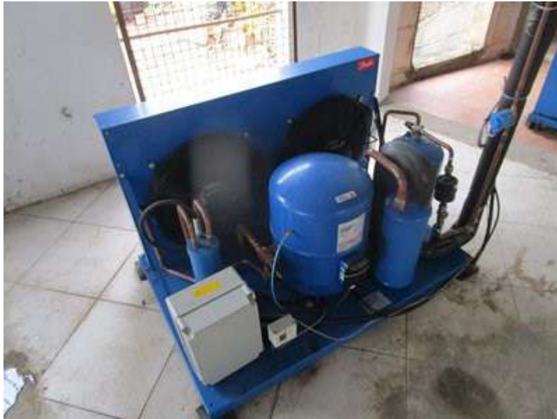
VISTAS DO COMPRESSOR
