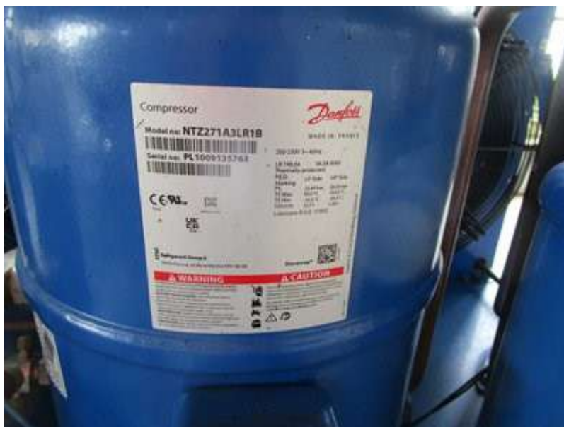
VISTA DA PLACA IDENTIFICAÇÃO DOS COMPRESSORES
